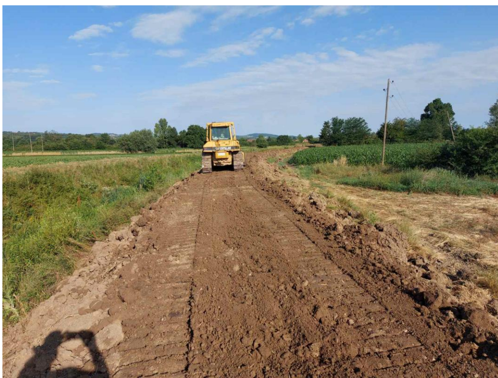
Надвишење левообалног насипа потока Бошњак
