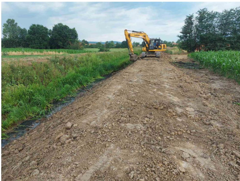
Надвишење левообалног насипа потока Бошњак
