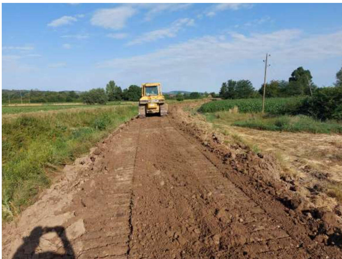
Надвишење левообалног насипа потока Бошњак
