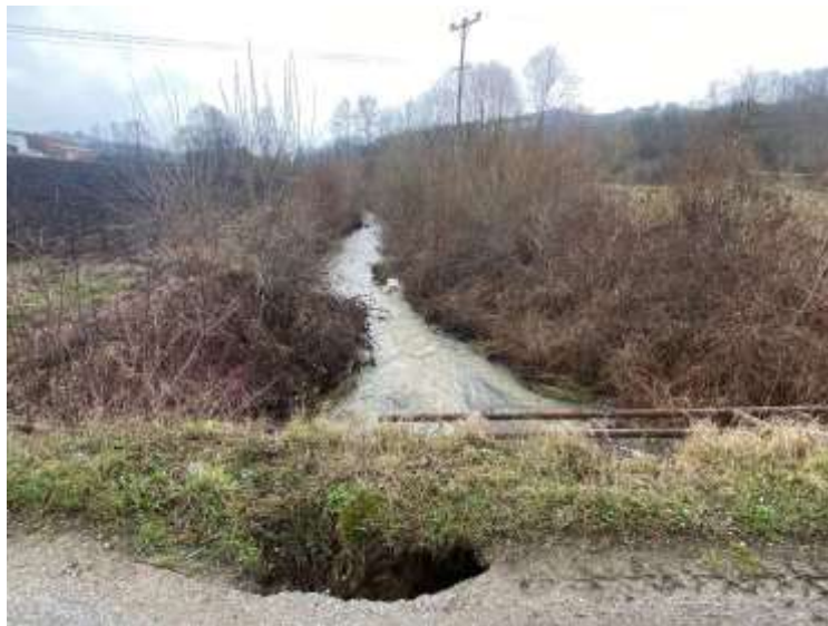
Оштећење цевастог пропуста на локалном путу
