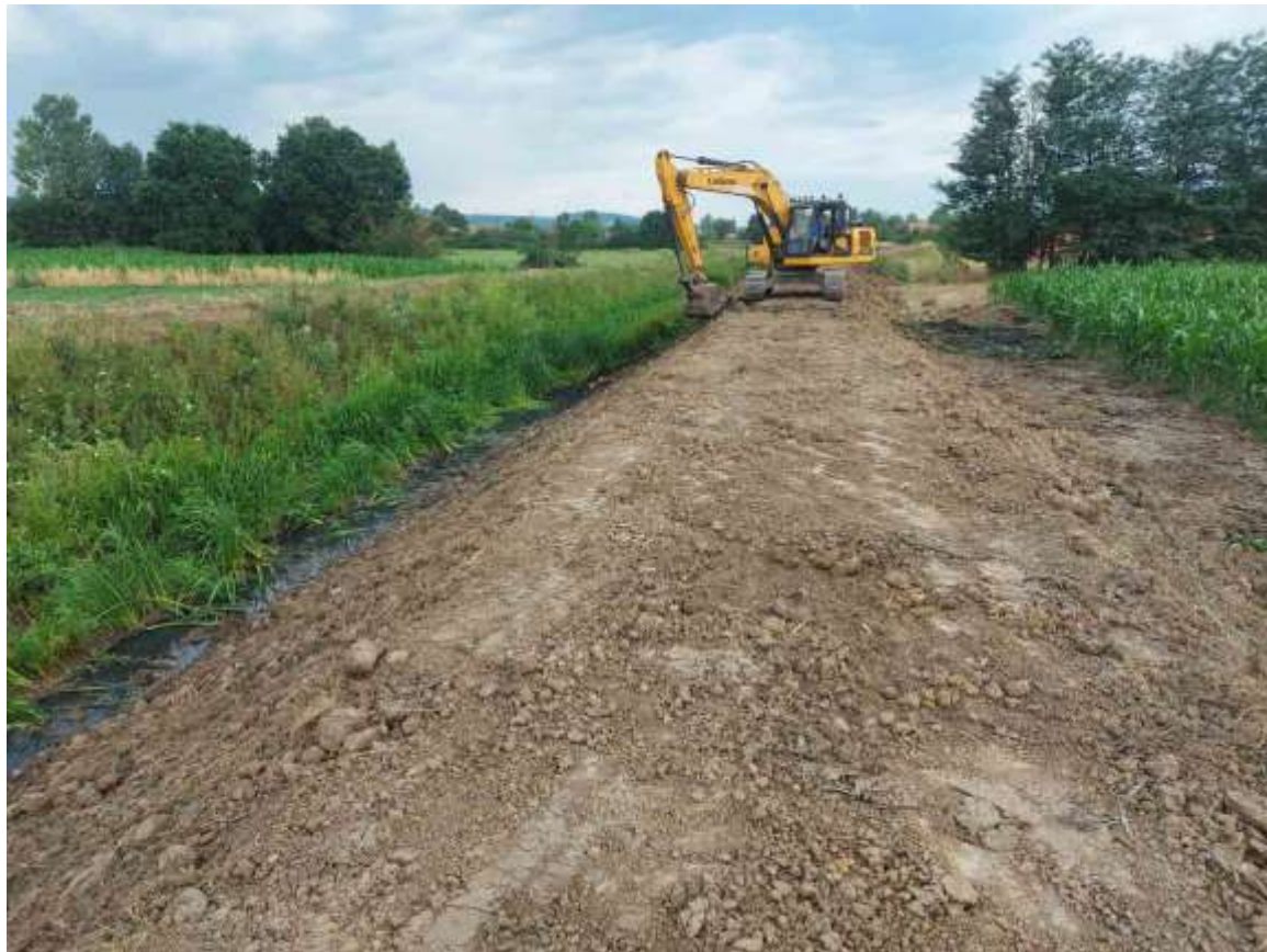
Надвишење левообалног насипа потока Бошњак
