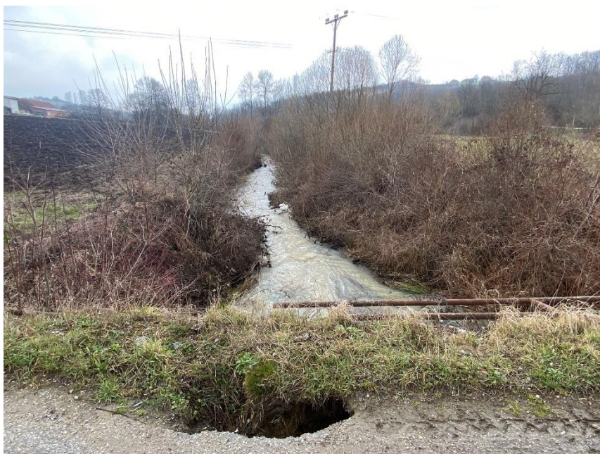
Оштећење цевастог пропуста на локалном путу
