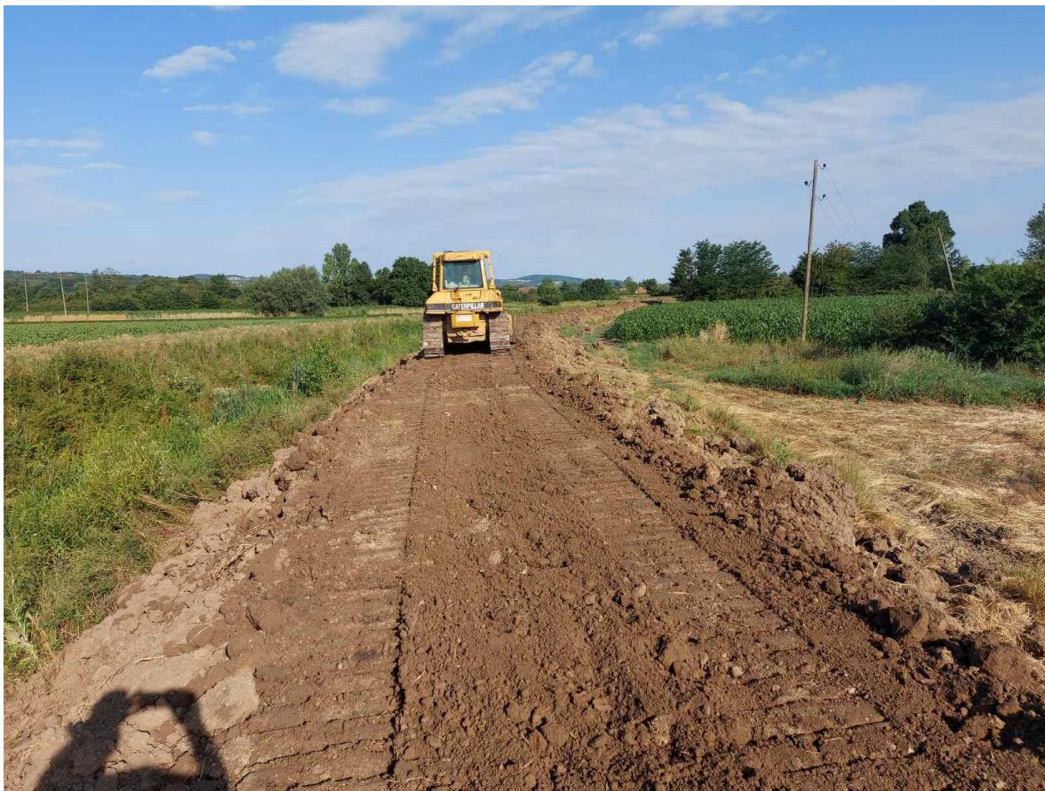
Надвишење левообалног насипа потока Бошњак
