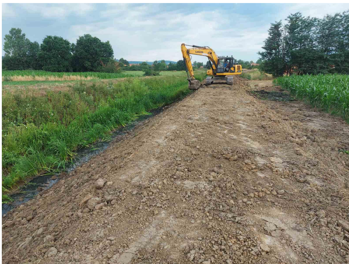
Надвишење левообалног насипа потока Бошњак
