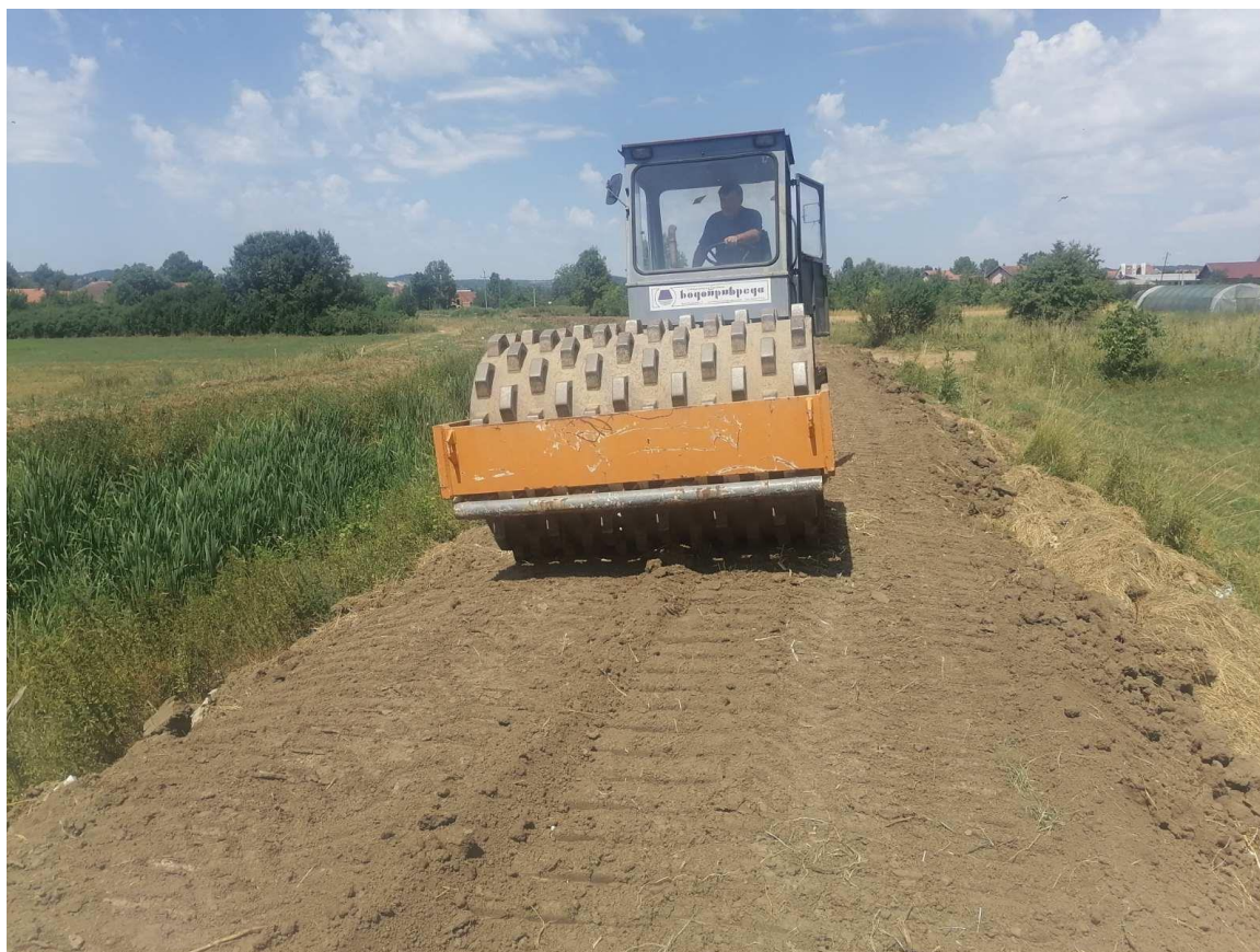
Надвишење левообалног насипа потока Бошњак
